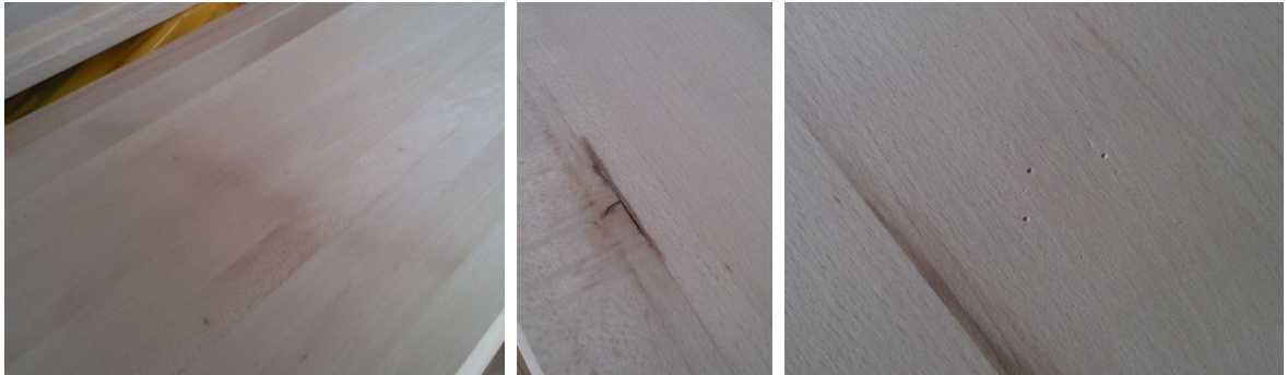
Abb. 5: Verfärbung durch Stapellatten, Risse und Insektenbefall (Bilder: Lüthi)
